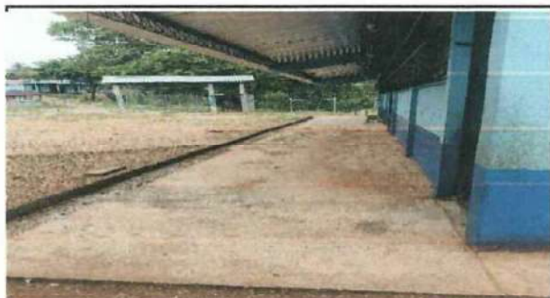
Foto 4: mejorar y reparar este piso .
